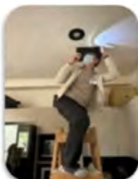
天花板漏水檢查
